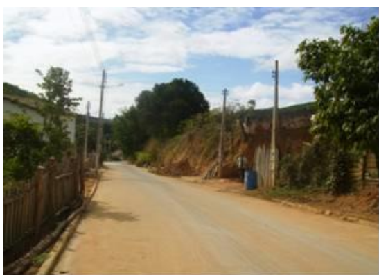
Figura 3.12: Escorregamento próximo ao cemitério.
