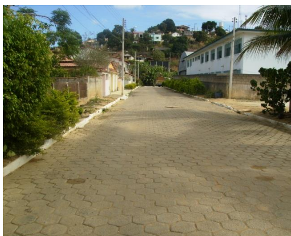
Figura 3.11: Área de alagamento – Centro.
